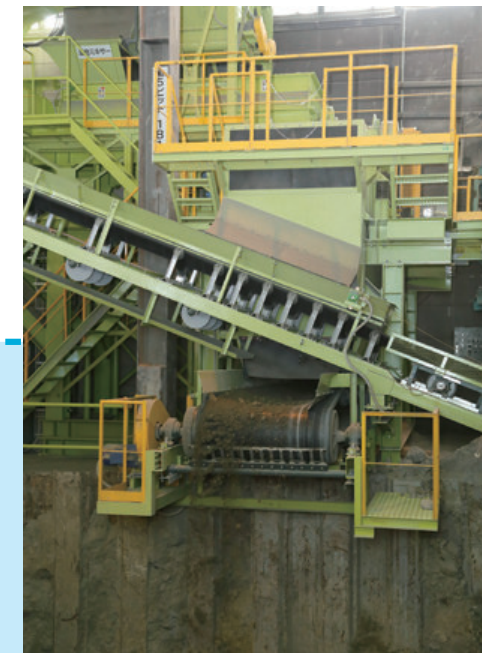
粒度調整篩・製品保管ピット
